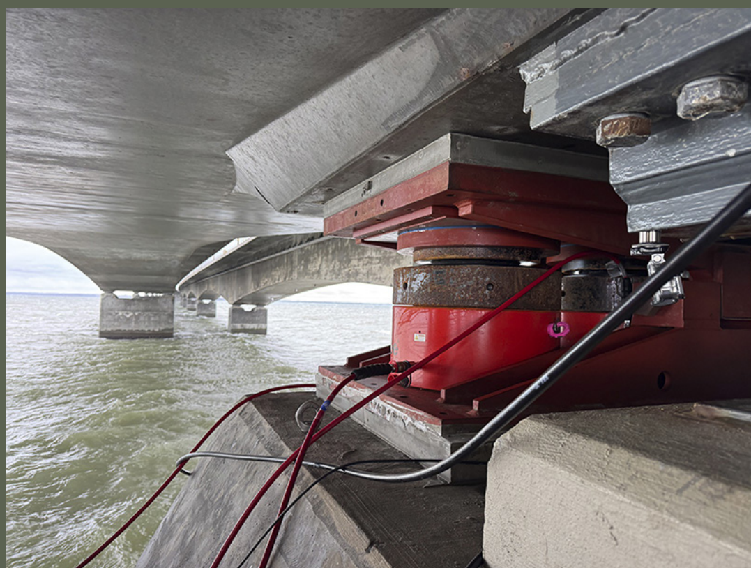
Sådan ser de specialdesignede donkrafte ud, der kan løfte broen 20 mm. Det frigør lige præcis nok plads til, at de glideplader, broen hviler på, kan udskiftes.
